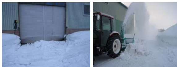
落雪によるシャッターの破損(1月19日)
