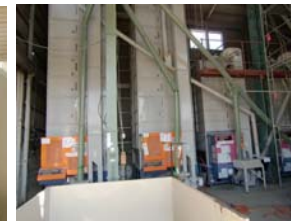
稼働する4台の乾燥機(9月29日)
