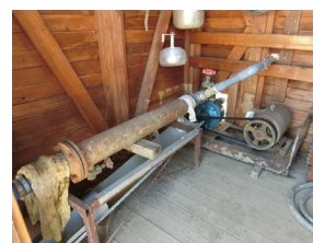
ポンプ小屋内部(5月19日)
